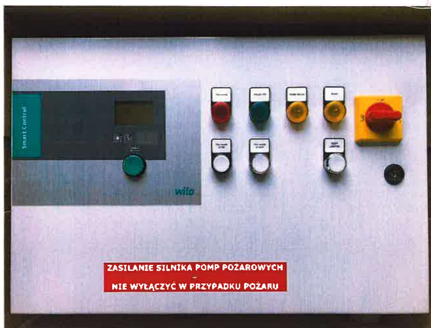
Rys. 3 Wygląd sterownika zespołu pomp pożarowych (Na przykładzie sterownika SCe-FIRE 4x10A)
