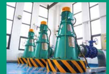
Wilo-Technologie ist im Einsatz in einem Wasserwerk in Xiong'an.
