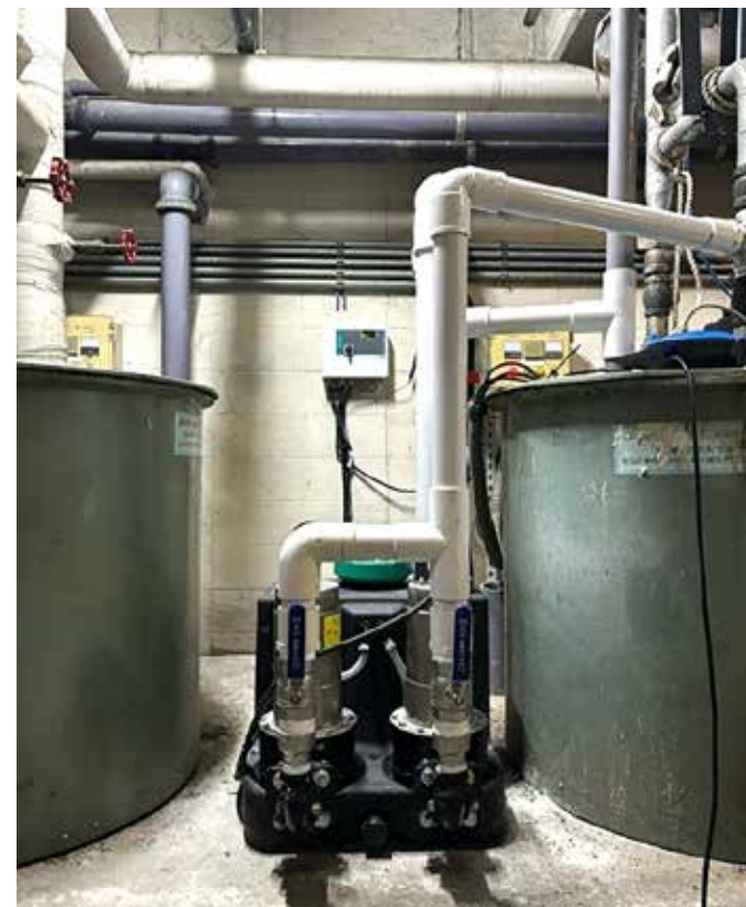
월배 아파트 현장 기존 오배수 패키지에 흡입/토출 배관만 연결해 기존 시설 철거없이 경제적으로 교체
