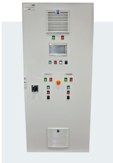
□ Фото 1. Современная система автоматизации насосного агрегата
