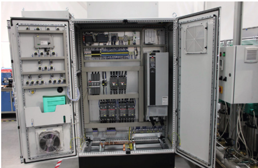
❖ Фото 3. Система автоматизации насосного агрегата с комбинированным типом пуска
