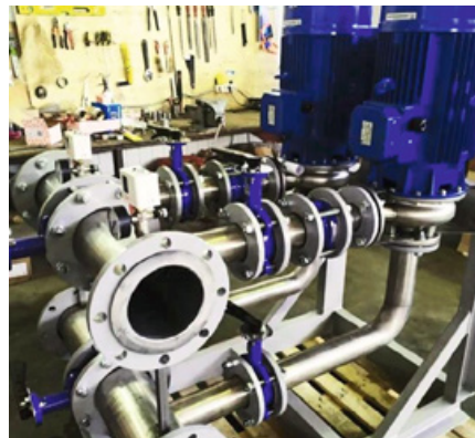
:: Рис. 3. Пример насосной установки с нарушениями в обвязке
