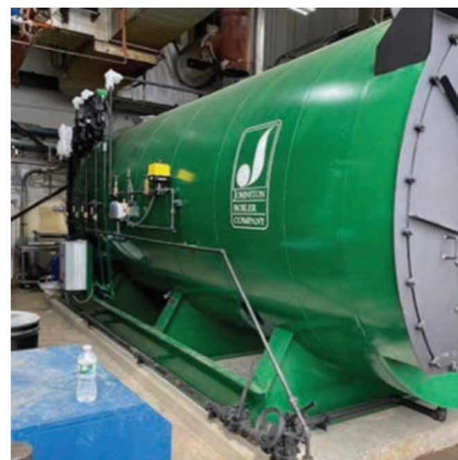
Рис. 2. Этот котел от Johnston Boiler Co входит в состав оборудования для модернизации коммунального комплекса кампуса колледжа Уэллсли
