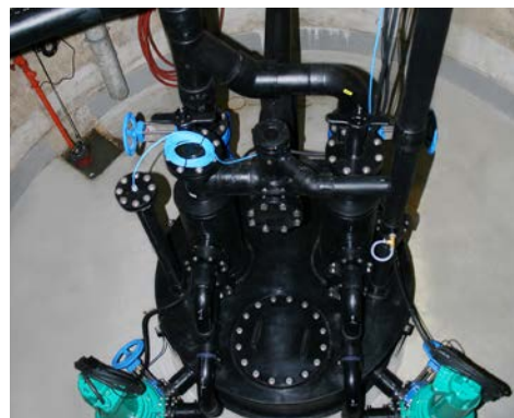
Tłocznia PEHD w studzience betonowej
