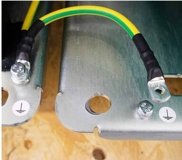
Erdung zwischen den beiden Grundplatten.
