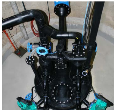
Tłocznia PEHD w studzience betonowej
