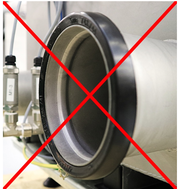
ACHTUNG! Falsch montierte Dichtung.
