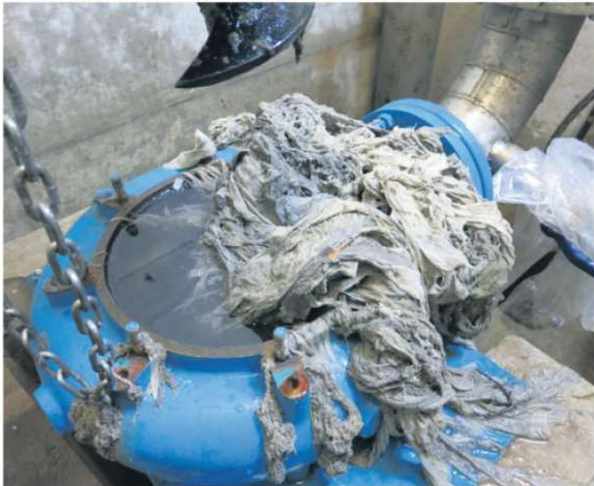
Blockiert: Eine Pumpe der ARA Zwingen ist von Feuchttüchern blockiert und muss auseinandergeschraubt und entstopft werden.
