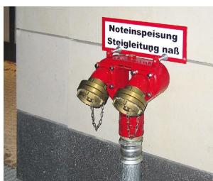
Löschwassereinspeisung ohne Schrank, mit Anschluss unten
