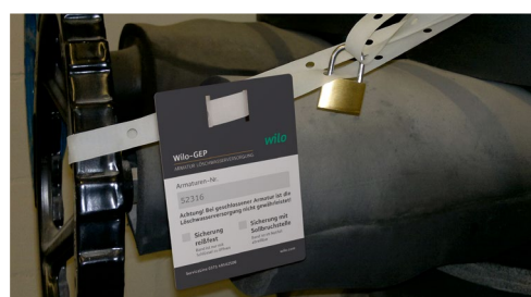
Praxisbeispiel der Absicherung einer Armatur
