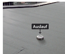
Integration im Dach – Ableitung auf Dach.
