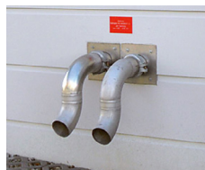
Integration in Fassade – Ableitung auf Verkehrsfläche.
