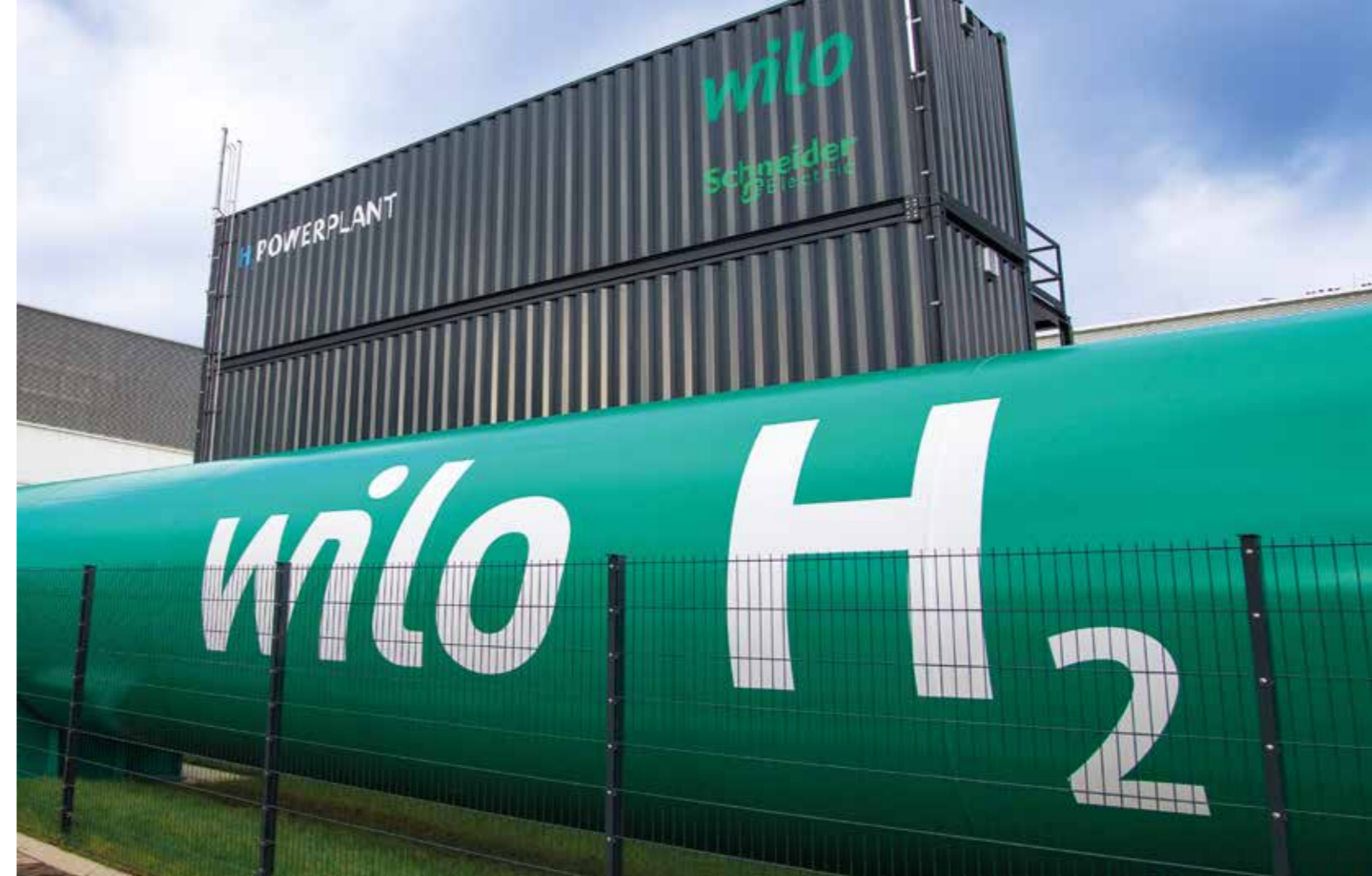
Die Wasserstoffpilotanlage H 2 POWERPLANT auf dem Wilopark, dem Unternehmenshauptsitz in Dortmund, ist ein wichtiger Bestandteil des Wilopark-Energiekonzepts, indem sie den mittels Fotovoltaikanlage auf dem Factory-Dach gewonnenen Strom speichert und bei Bedarf abgibt.
