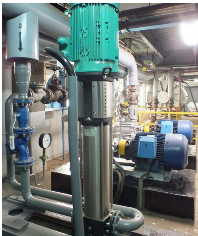
Stan po modernizacji (w tle rodzaj wymienionej pompy)
